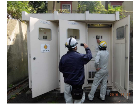
講堂奥キュービクル・図書館電気室の高圧トランスの表面温度の測定
