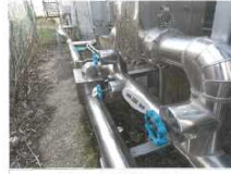
学生寮 右 電磁弁バイパス
