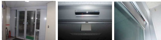
自動扉本体 自動扉感知 駆動状況
