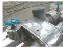
国際交流会館 左 電磁弁バイパス
